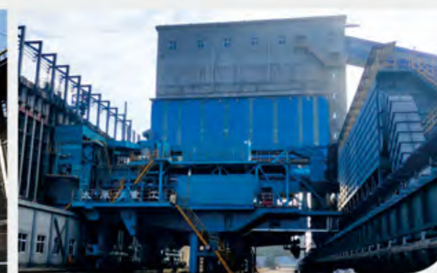
推焦车地面站式除尘系统
